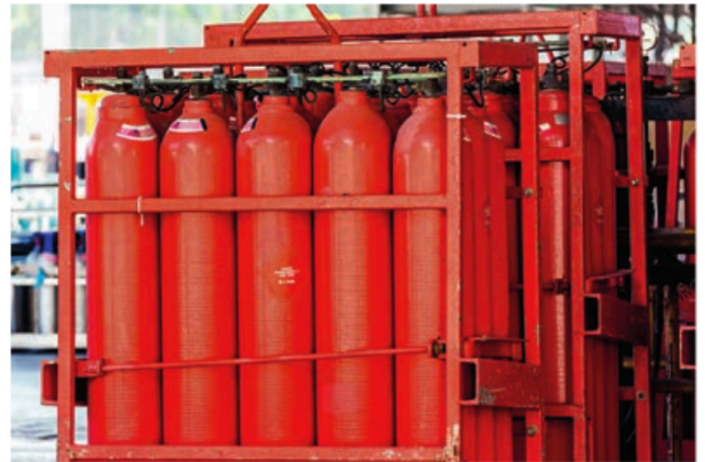
Stockage sous pression du dihydrogène.
